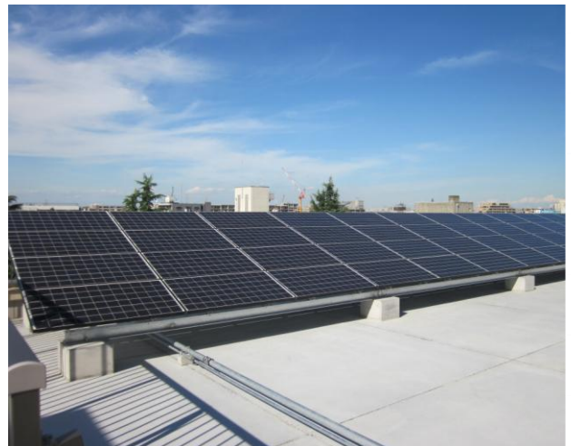
【4階の太陽光パネル】 H24.9.10撮影
